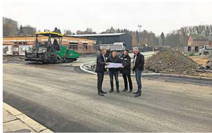
Unser Foto zeigt 1. Bürgermeister Frank Stumpf, Jörg Hohenberger, Stadtbauamt Naila, Jürgen Gutmann, Bauleiter der Firma Rädlinger, Ralf Bütting, Geschäftsführer USS Consult
