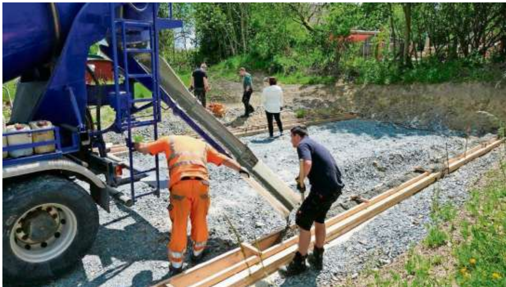
Nils Färber und Holger Welte (von links) werkelten beim Arbeitseinsatz zur Fundamenterstellung mit.
