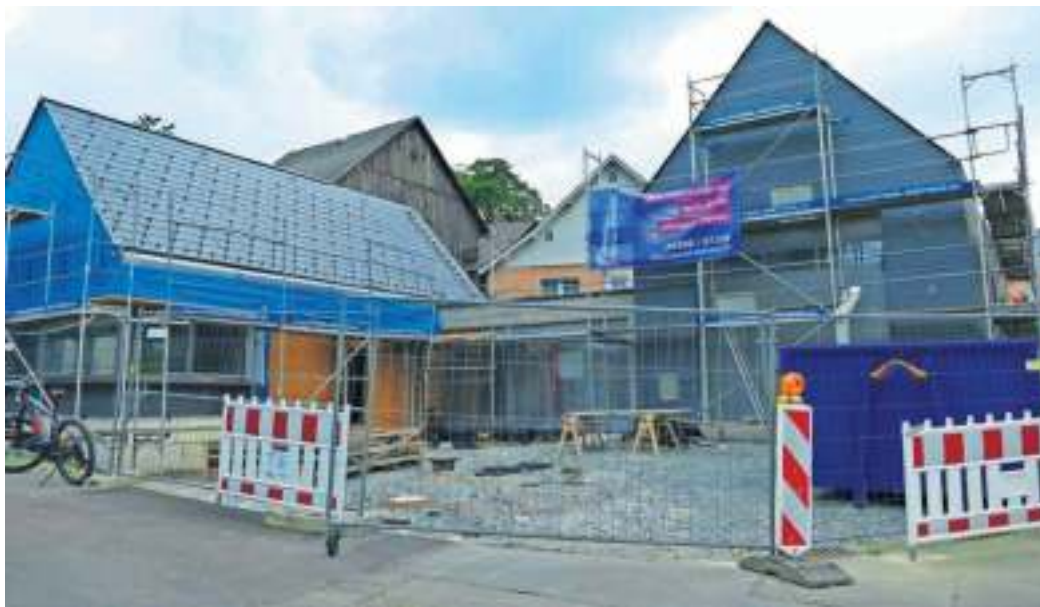
Das Feuerwehrgerätehaus bekommt einen Stellplatz, einen Verbindungstrakt mit Sanitäreinrichtungen, Umkleiden für die Brandschützer und einen Technikraum. Das Flachdach des Verbindungstrakts wird bepflanz.
