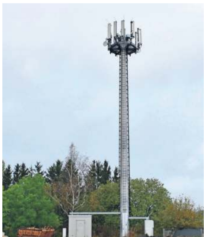
Mobilfunkmast am Stadtbauhof
