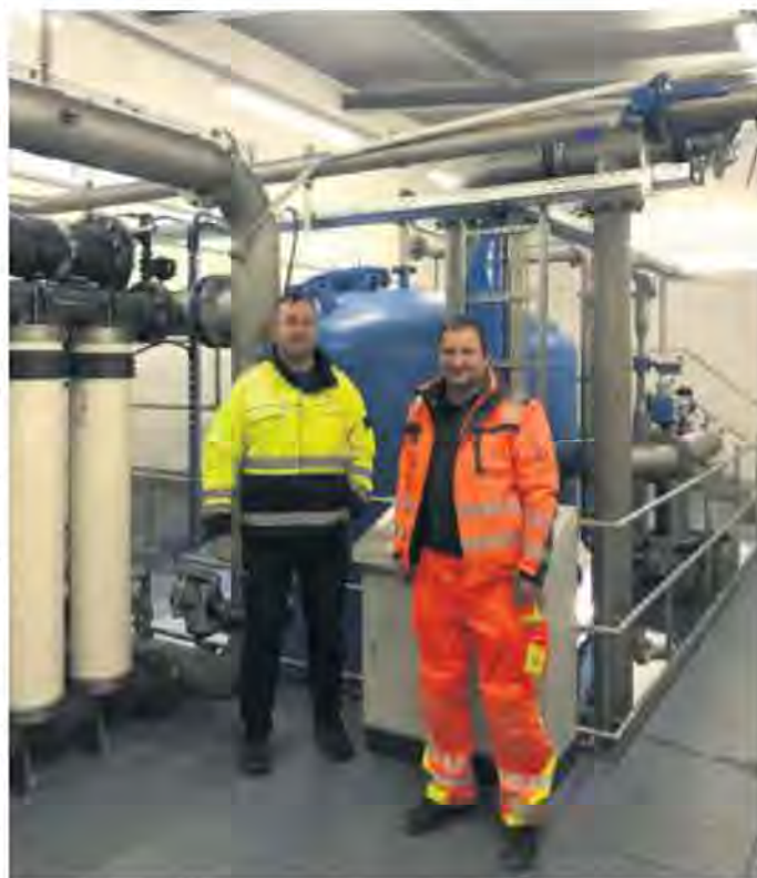
Das Bild wurde in der Trinkwasseraufbereitungsanlage Naila aufgenommen und zeigt von links: Wassermeister Klaus Gädtke den stellv. Wassermeister Jürgen Hohberger.
