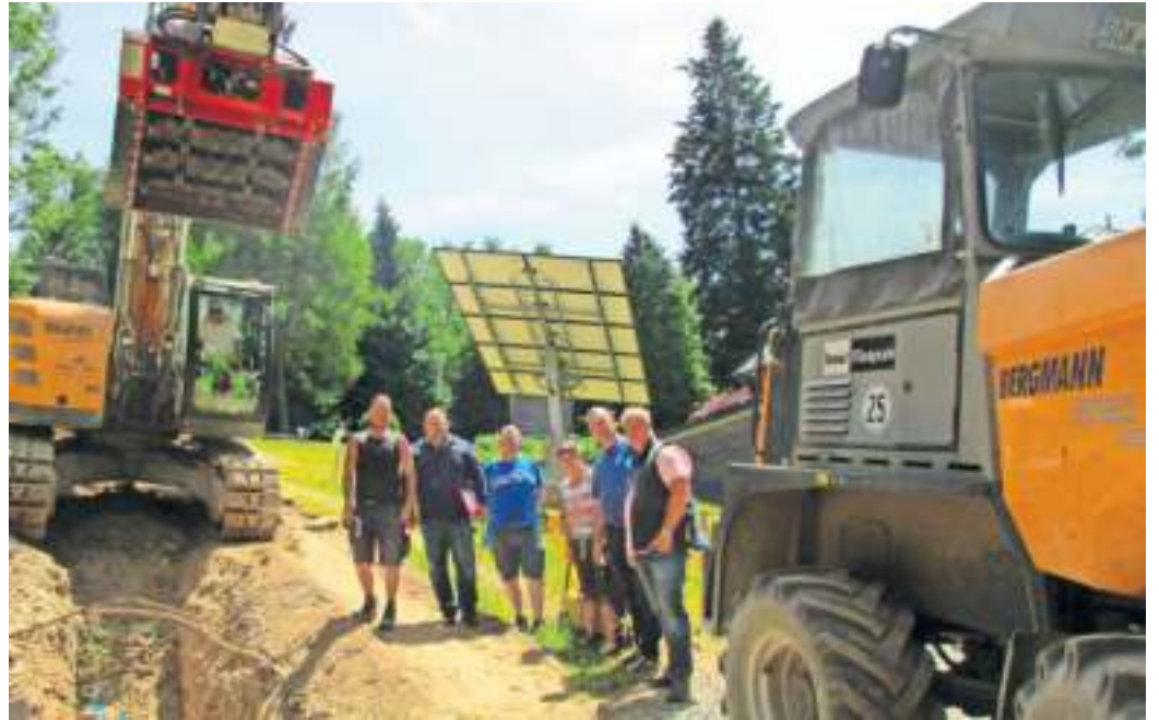
Das Foto zeigt von links: Herrn Nitzsche (Polier, Firma Schwall & Mayer), Thomas Walther (Bauamt, Stadt Naila), Lars Bubner (Bauleiter, Firma Schwall & Mayer), Andrea Ständner (Grundstückseigentümerin), Klaus Gädtke (Wassermeister, Stadt Naila), Frank Lailach (Bauleiter USS-Consult GmbH)
