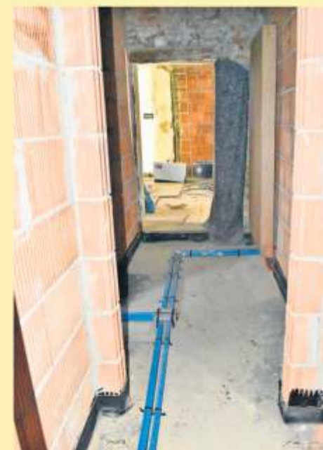
Heizungsrohre am Boden
