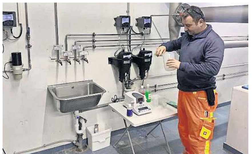
Prüfen von Trinkwasserparametern in der Trinkwasseraufbereitungsanlage Naila.
